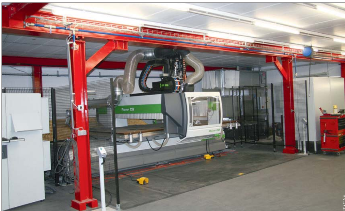
De nieuwe C.A.E.-vestiging in Bande werd uitgerust met een betrouwbaar persluchtnet. Het bedrijf koos voor het Infinity-systeem van Pnevano.
