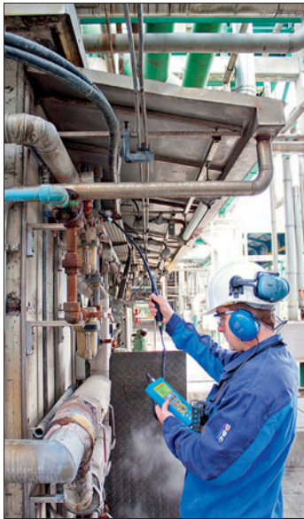
Perslucht via een buizenstelsel met schroefverbindingen is een bron van kleine lekken; maar vele kleine maken één grote
