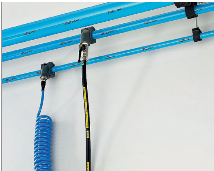
Het aanleggen van een perslucht netwerk is de facto ook specialistenwerk vanwege de gebruikte verbindingstechnieken
